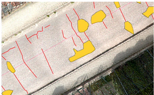
Skador i beläggningen kan vara längs- eller tvärgående sprickor, krackeleringar eller liknande. Allt visualiseras i SINUS som ytor eller linjer likt bilden.
